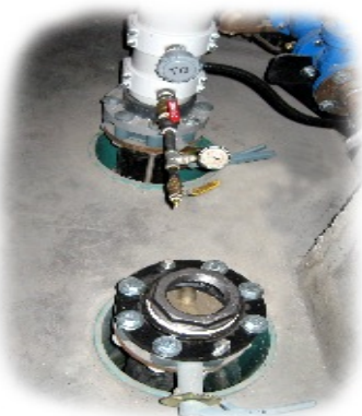
Líneas geotérmicas de alimentación y retorno
