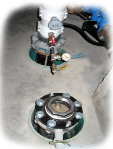
Geothermische Versorgungs- und Rückflussleitungen
