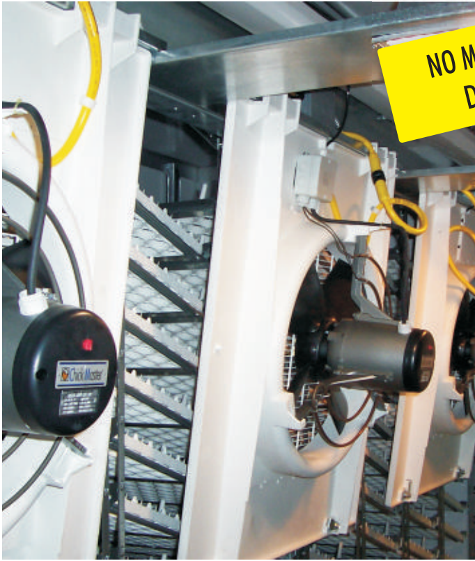
Calefactor de anillo y sistema cyclomist de humedad montados en el ensamble del tablero plástico del ventilador.
