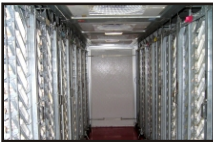
Pasillo de acceso central para facilitar mantenimiento y limpieza
