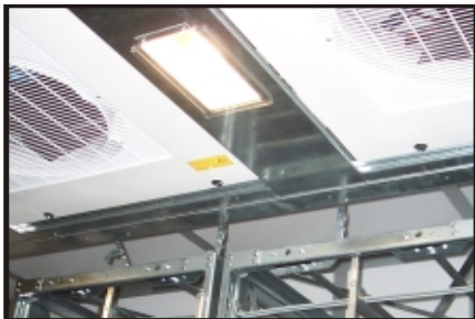
De fácil limpieza con tableros plásticos de ventiladores e iluminación de alta intensidad
