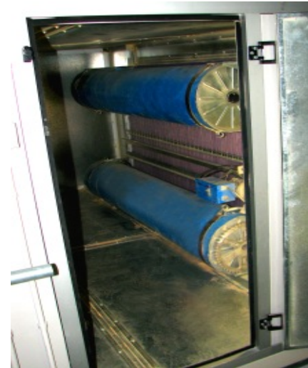
El ducto de la nacedora, filtro automático de rollo
